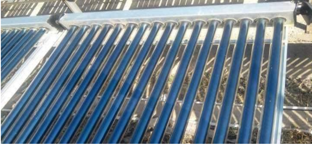
Şekil 9. Sera sisteminde kullanılan vakum tüplü güneş kollektörü
