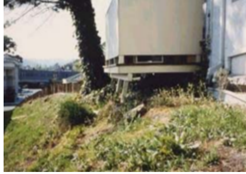
Şekil 1. Zemin gerilmesi/şişmesi’nden kaynaklanan bina oturmasına bir örnek (Aydın ve Uygur, 2000)
